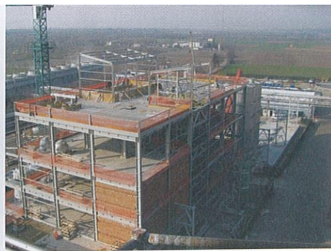
◀ Il nuovo impianto, la cui entrata in funzione è prevista per la fine del terzo trimestre del 2012, è ubicato nel sito di Roquette di Cassano Spinola, in Italia
